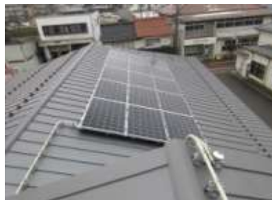
頓原複合施設へ太陽光発電設備設置
